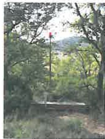
Aération et système d'alerte de niveau bas
