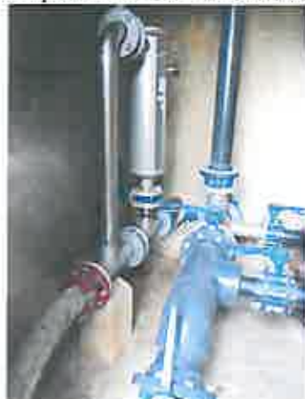
Conduite d'arrivée et filtre
