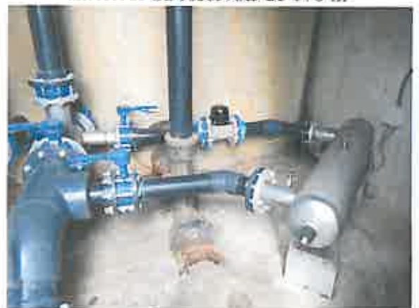
Conduite de départ et filtre UV
